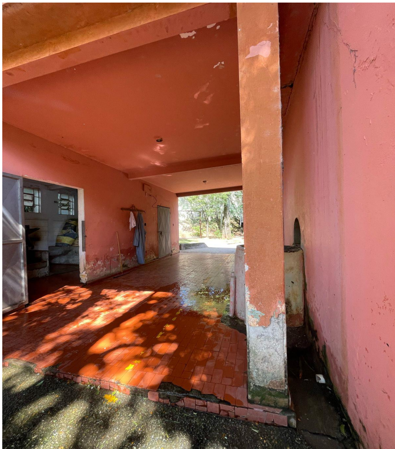
Imagem 3 – Espaço localizado atrás dos três galpões, onde se encontram dois bebedouros e uma sala destinada à trituração da alimentação de Sandro. O local apresenta infiltrações, rachaduras, ausência de iluminação e uma faixa amarela de segurança quase apagada. (Arquivo pessoal, 2025).
